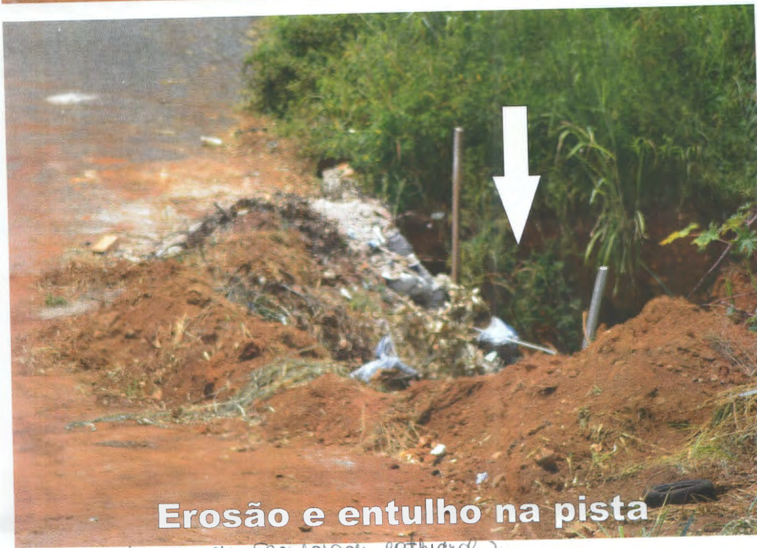
Erosão e entulho na pista
