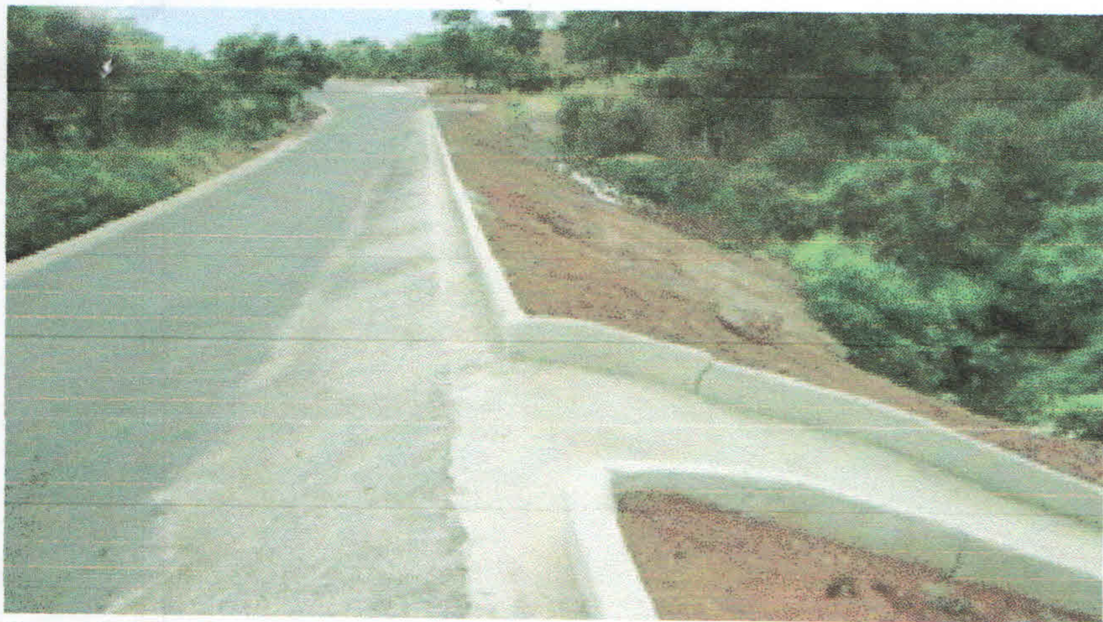
Foto 9 - Rachaduras no espaço de escoamento da água da chuva
