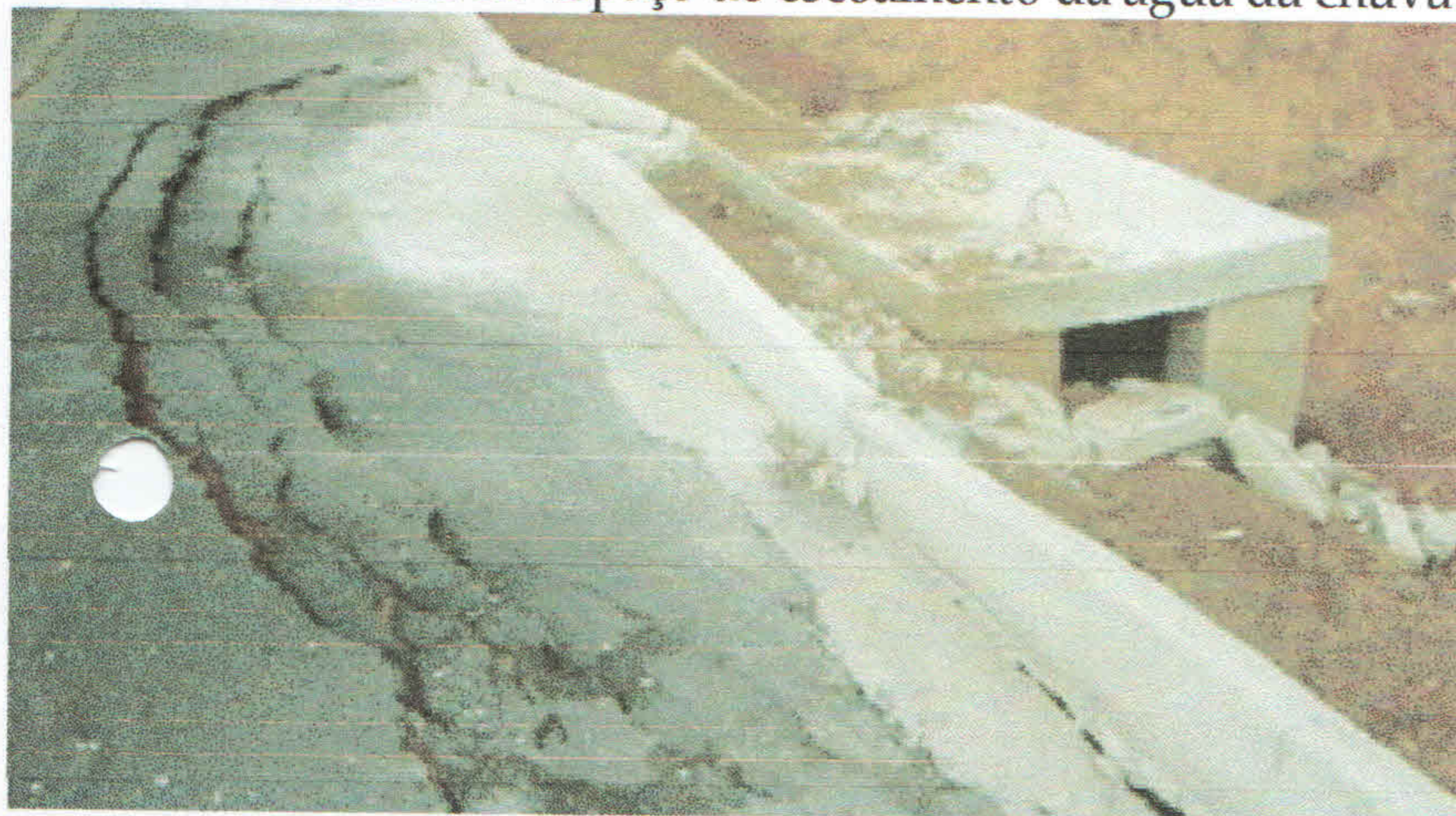
Foto 11 - Asfalto novo e muito rachado
