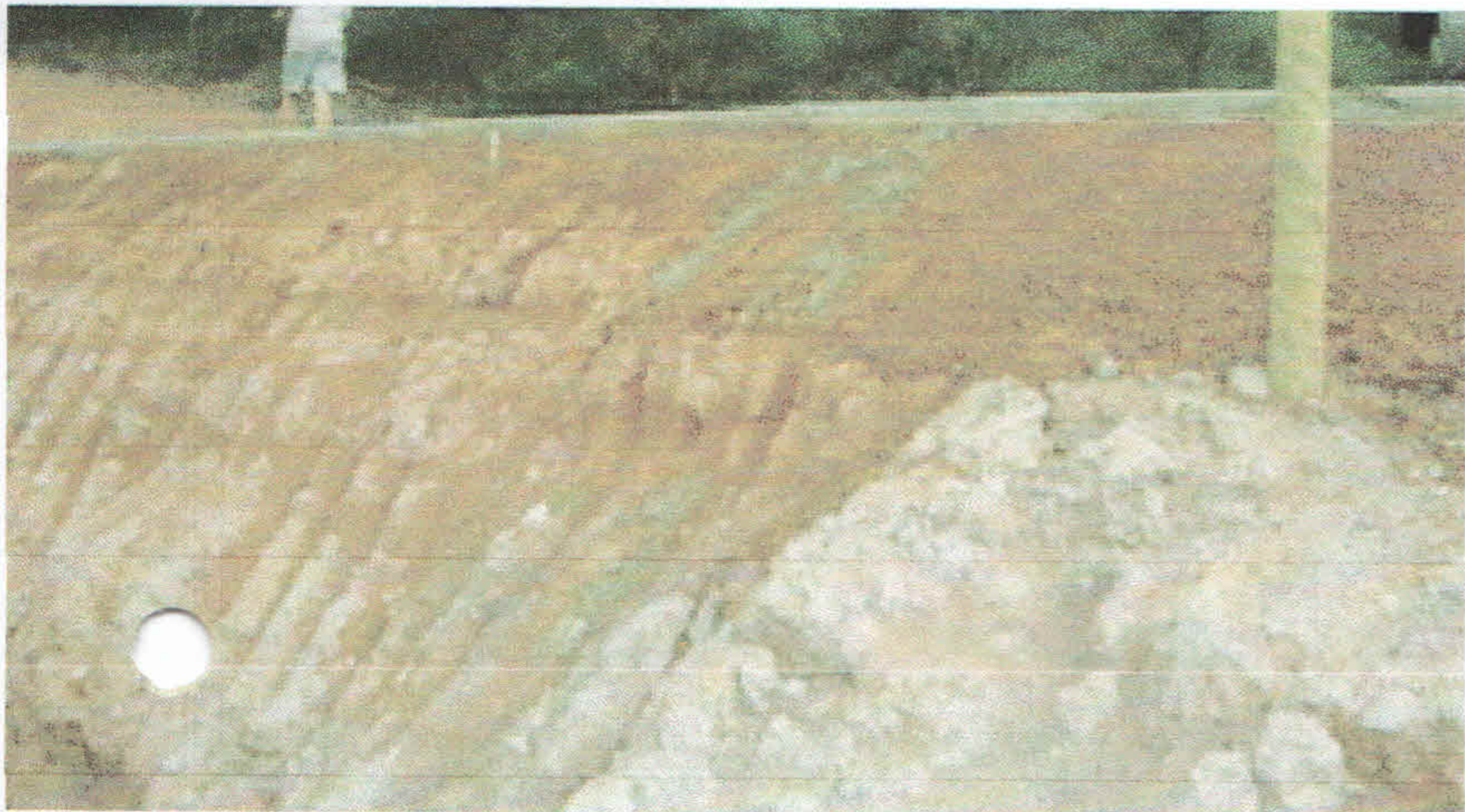
Foto 5 – Problemas com o aterro da pista
