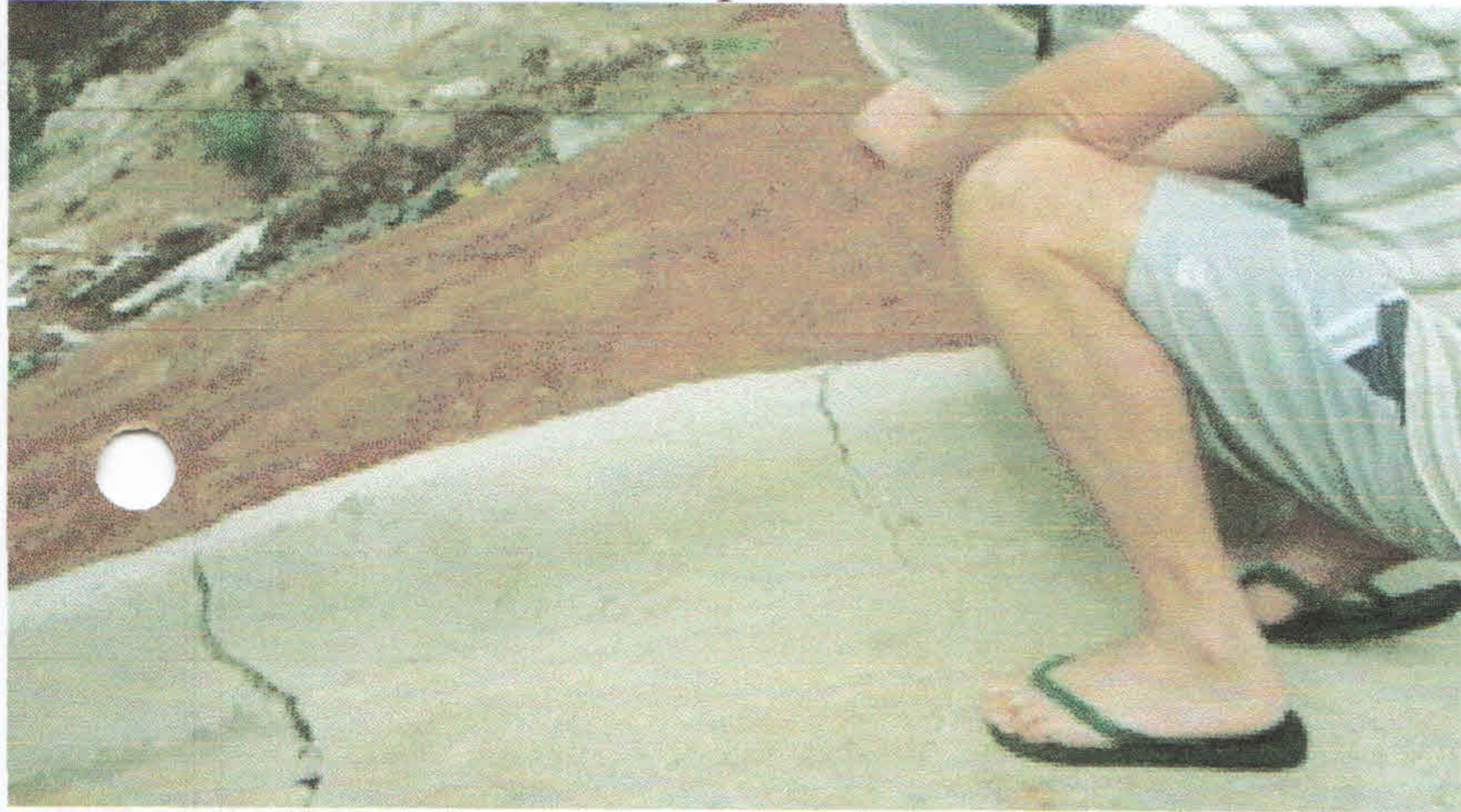
Foto 3 – Rachadura no meio-fio
