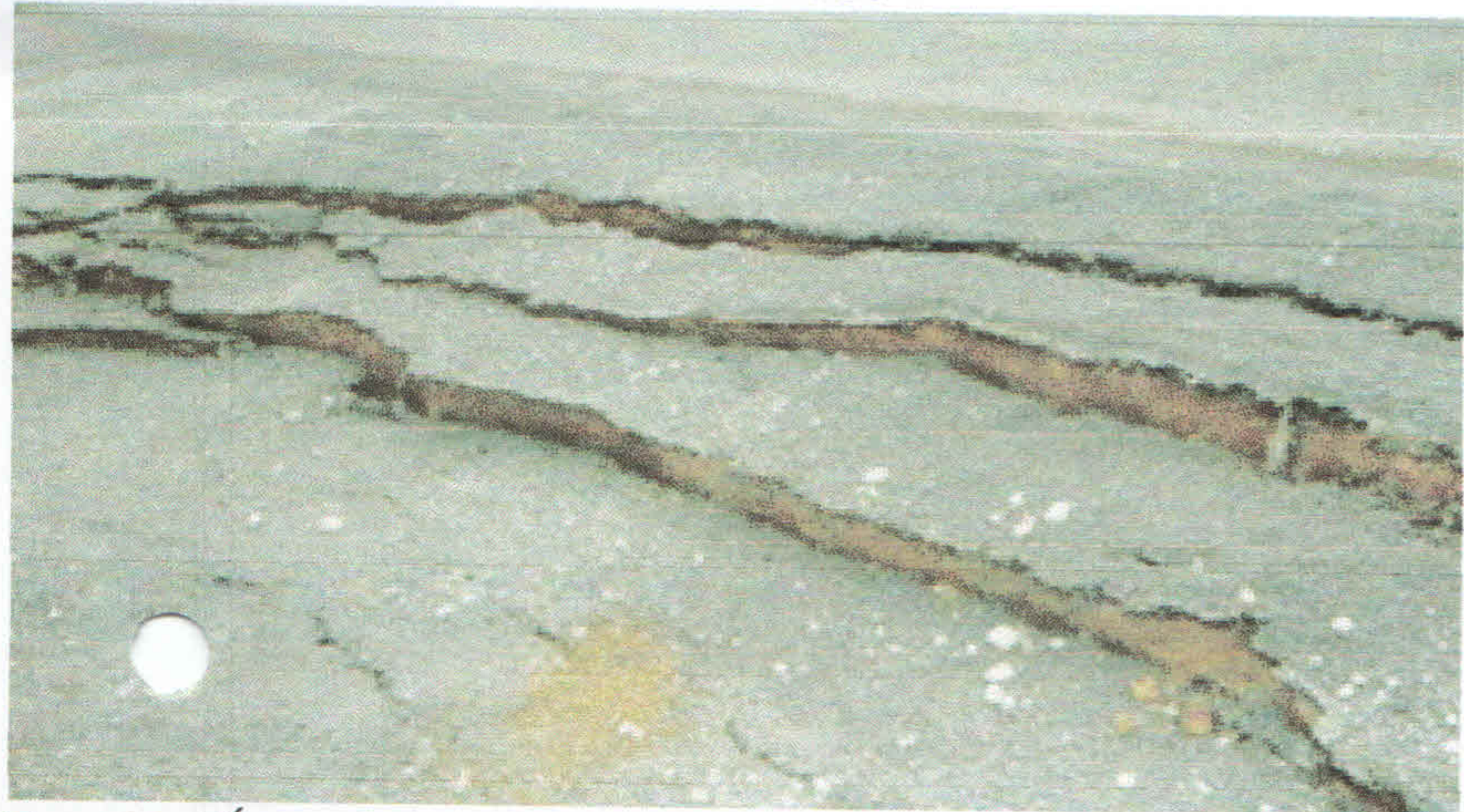
Foto 13 - É possível uma obra nova nesse estado?
