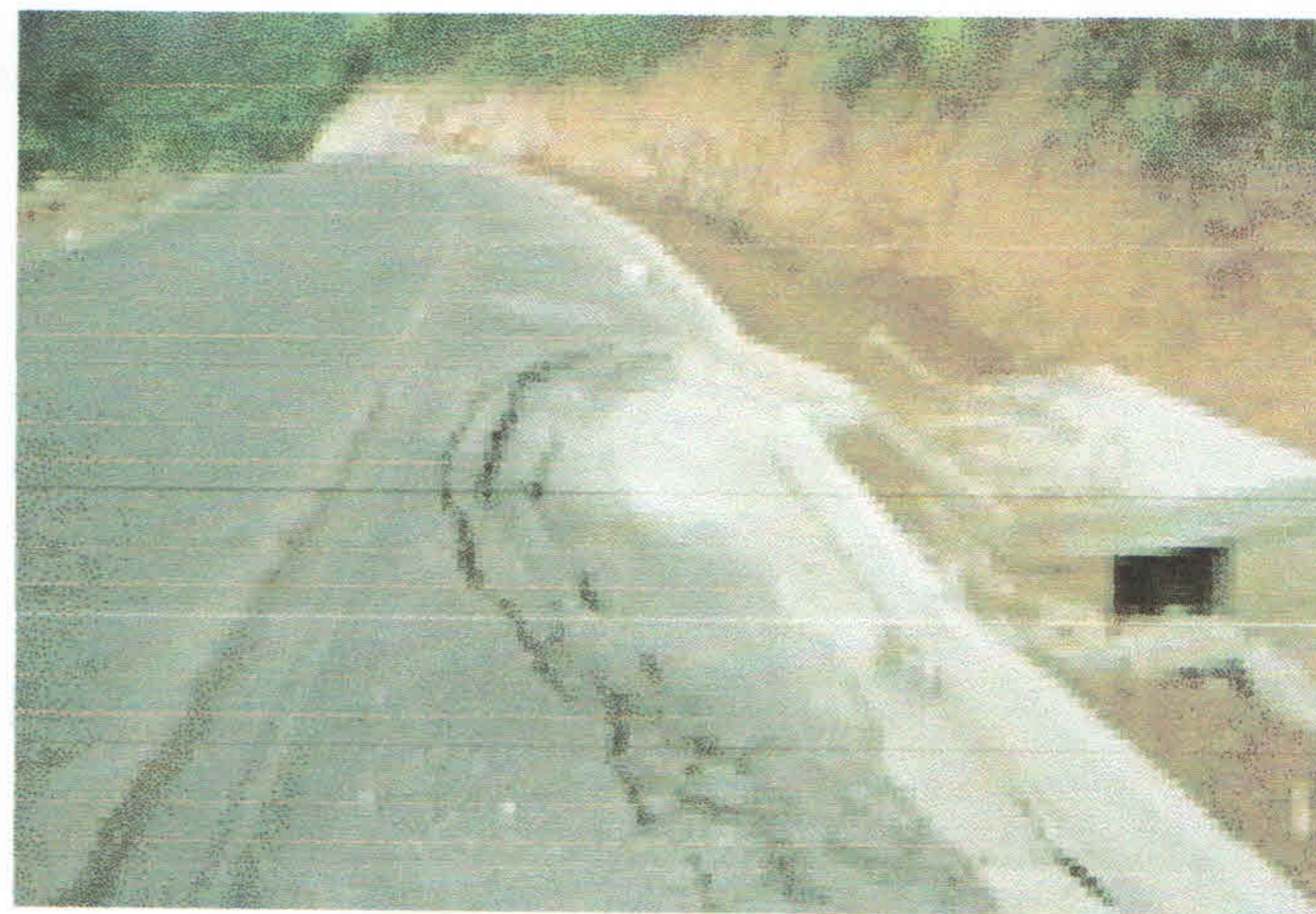
Foto 10 - Asfalto novo e rachado
